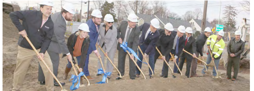
Um aspeto do lançamento da primeira pedra da Paiva Plaza em East Providence.
